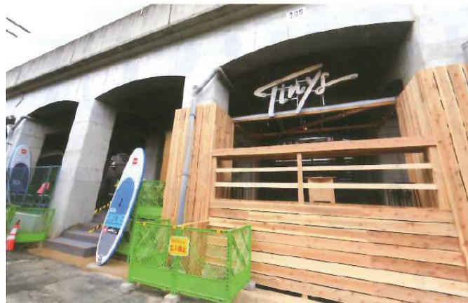
4月7日(土)に行なわれたプレオープンの様子。建設工事もうよいよ大詰め。撮影:豊田直之
