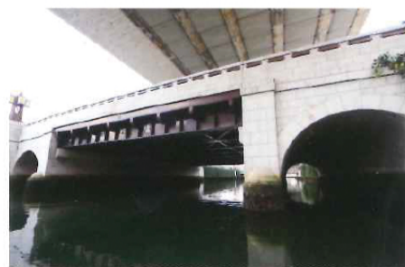
今年3月、横浜市に「歴史的建造物」として認定されたばかり。震災復興期の姿を伝える貴重な土木産業遺産でもある。
