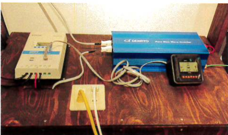
室内には蓄電池、チャージコントローラー、インバーターを設備。直流24Vを一般交流100Vに変換する。
